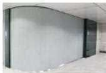
防火・防煙横引きシャッター
