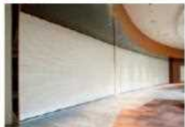
防火・防煙シャッター
