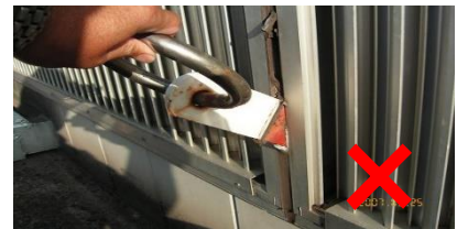
亀裂が入った危険な支持物の例
