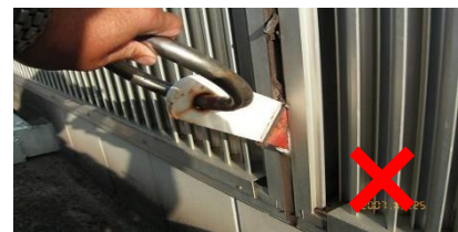
亀裂が入った危険な支持物の例
