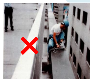
墜落防止措置が取られていない危険な事例
